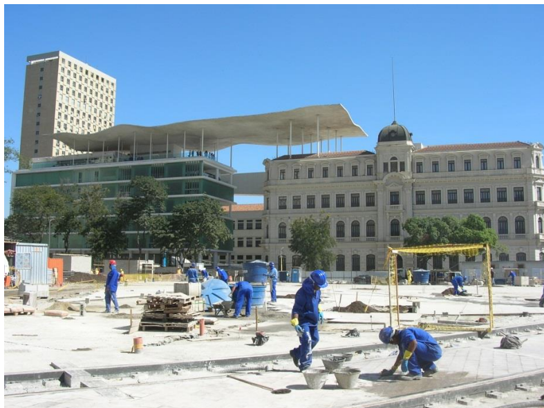
Figura 2 - Trabalhadores em ação nas obras do projeto Porto Maravilha, Praça Mauá, Centro da cidade do Rio de Janeiro. Ao fundo, Museu de Arte do Rio. (Foto: Caroline Alciones)
